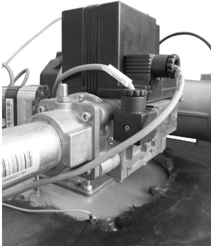
Fil de mise à la terre
